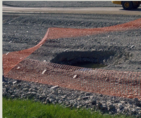
Senkungen an der Basis vom Damm
